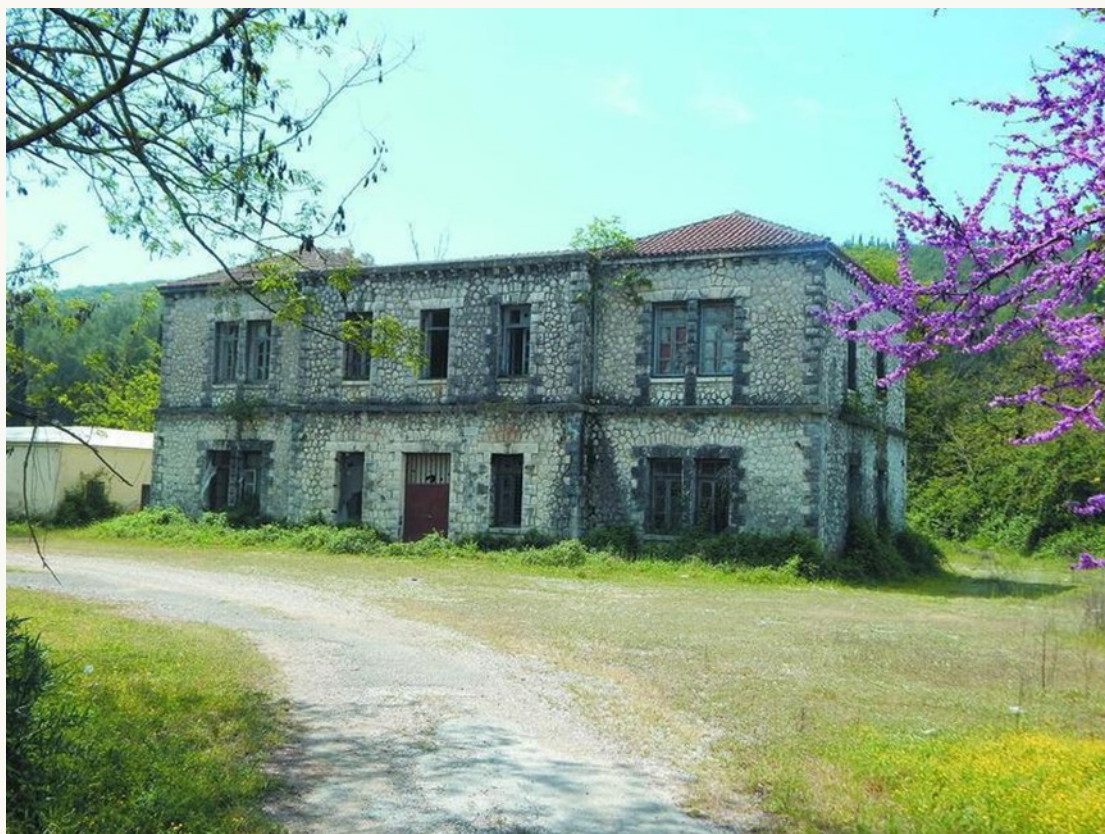
Εικ.33. Το κυρίως κτίριο του Στρατοπέδου Παπακώστα σε μεταγενέστερη περίοδο, με εμφανή πλέον τα σημάδια της εγκατάλειψης και της φθοράς του χρόνου. Παρά τον χαρακτηρισμό του ως διατηρητέου μνημείου, δεν έχουν ληφθεί ουσιαστικά μέτρα προστασίας και αποκατάστασης, με αποτέλεσμα σήμερα να βρίσκεται σε ακόμη δυσμενέστερη κατάσταση.
